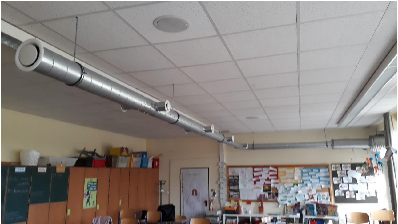
Abb. 1 Gesamtansicht der Abluftanlage (von der Tafel aus betrachtet)
