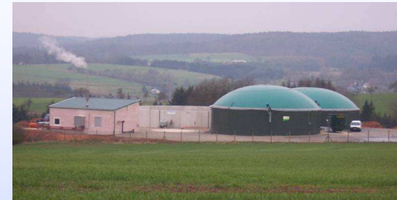
NaWaRo-Biogasanlage, Arenrath (Rheinland-Pfalz)
